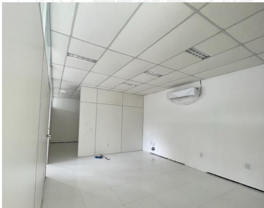
Figura 132 - Parte interna finalizada com ar condicionado instalado (agosto de 2023)
