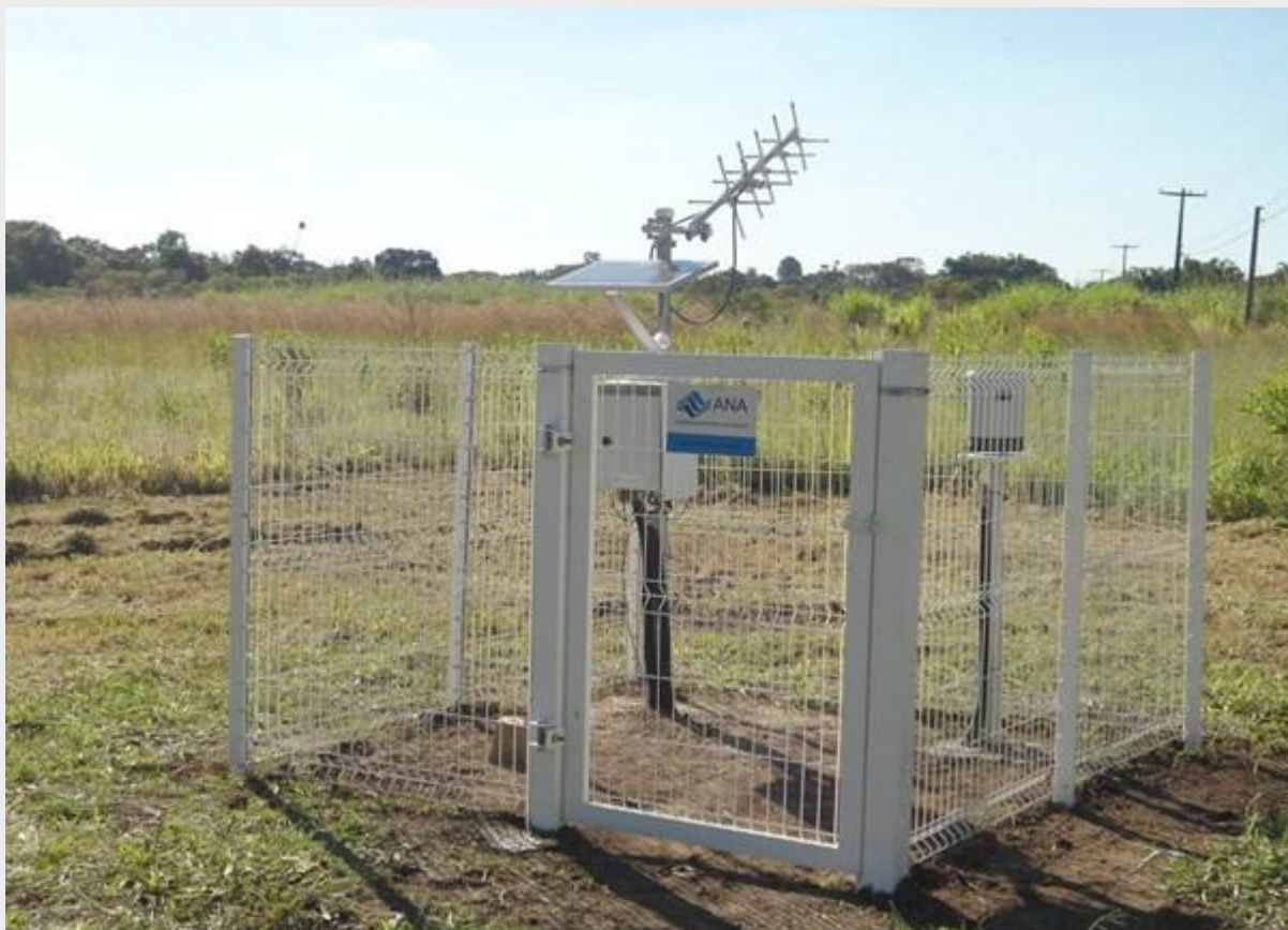
Foto da PCD instalada com cercado de proteção.
