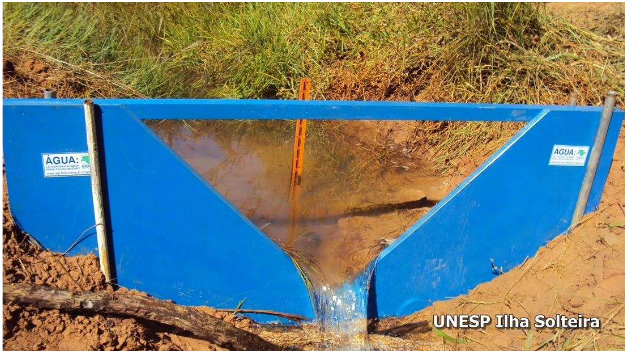
Figura 9-1 - Vertedor triangular em chapa metálica
