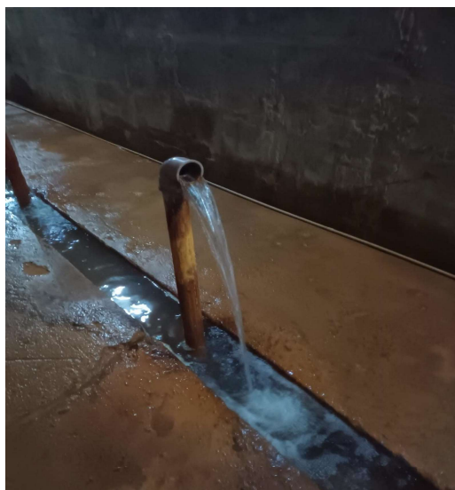
Figura 9-9 - Vazão de poço de alívio no interior da barragem Nova Camará.
