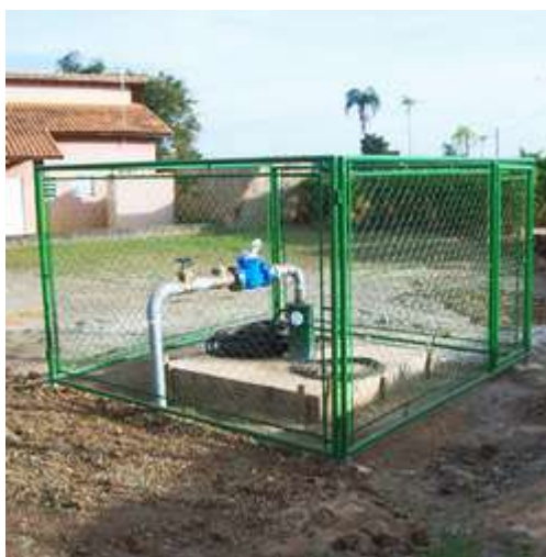
Figura 6-32 - Cercamento adequado de poço tubular
