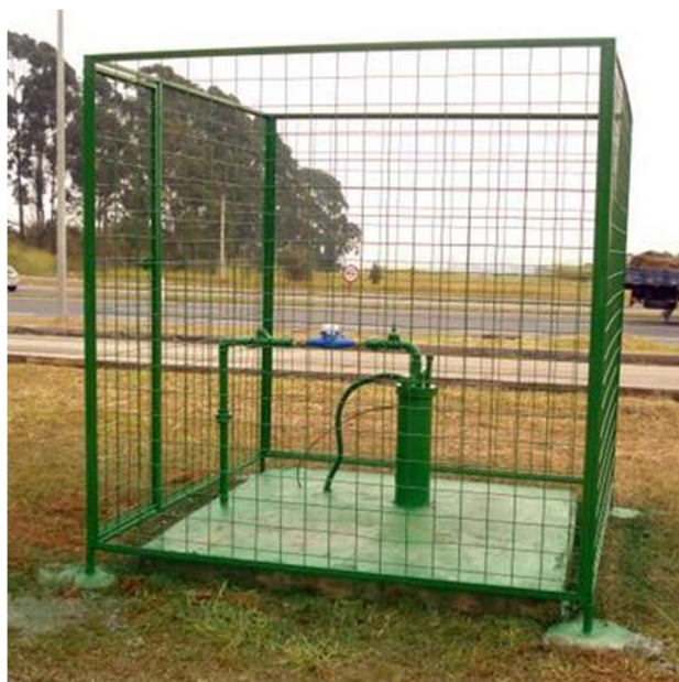
Figura 6-34 - Poço tubular equipado com bomba submersa.
