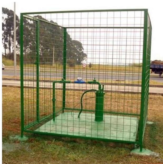
Figura 6-35 - Poço tubular equipado com bomba submersa
